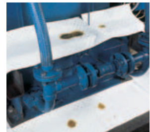
Вокруг машинного оборудования для сбора протечек
